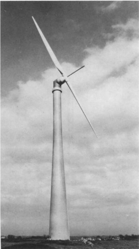
25. Gotland wind generator (Sweden).
